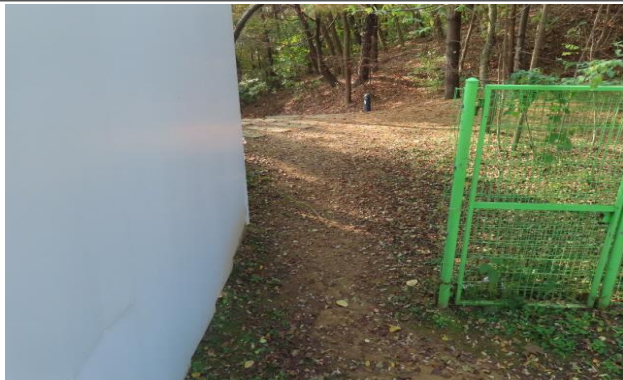
웬스 능형망 파손
