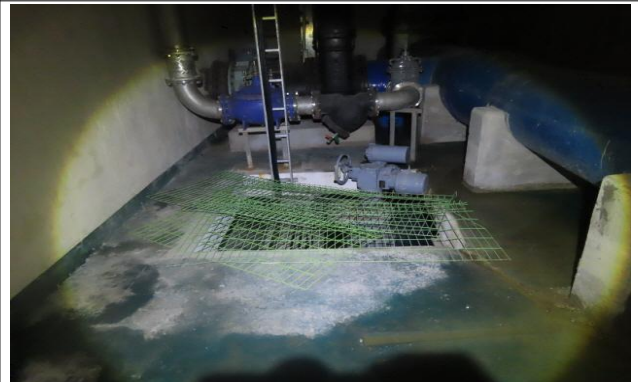
유입 밸브실 장비투입구 안전난간 미설치
