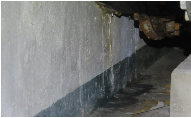
지하1층 벽체 백태
