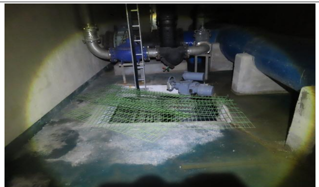
유입 밸브실 장비투입구 안전난간 미설치
