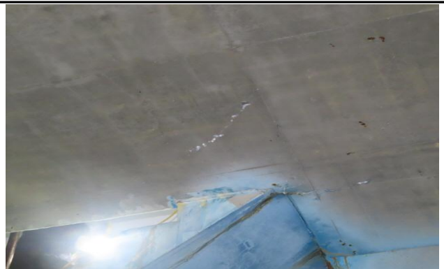
배수지 2지 상부슬래브 백태
