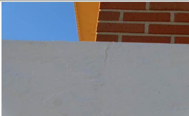
밸브계단실 외부 균열(0.3mm미만)
