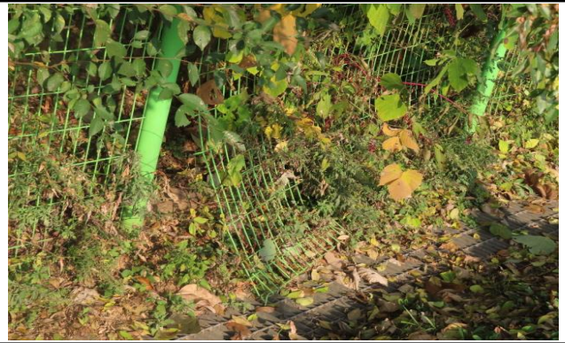
웬스 능형망 파손
