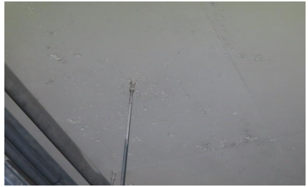
지하2층 상부슬래브 재료분리
