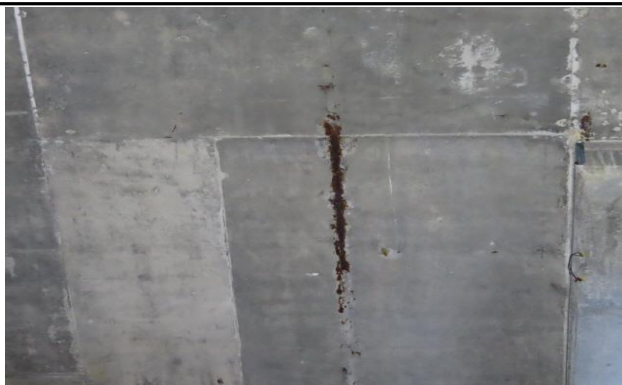
배수지 2지 상부슬래브 철근노출
