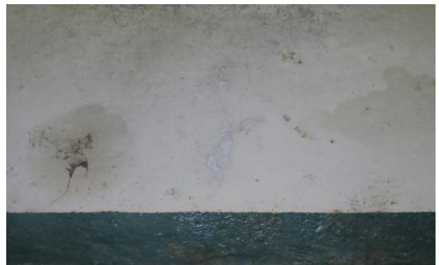
지하2층 벽체 백태
