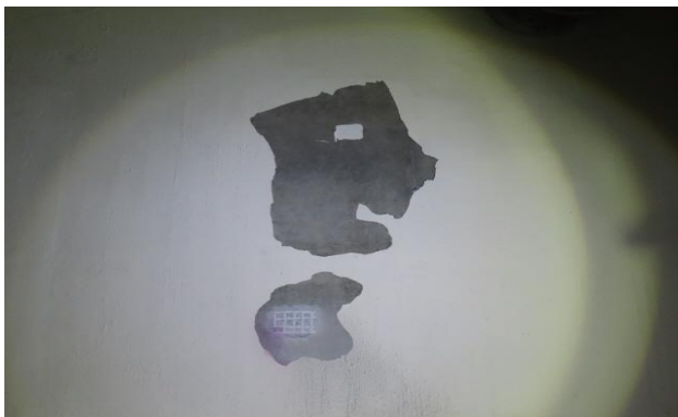
지하2층 벽체 도장박리
