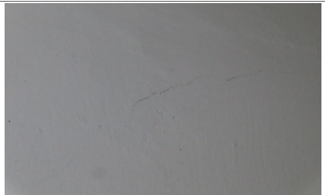
계단실 2지 내부 몰탈균열
