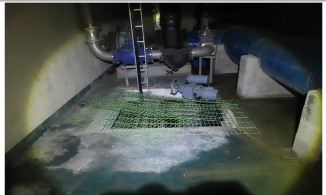
유입 밸브실 장비투입구 안전난간 미설치
